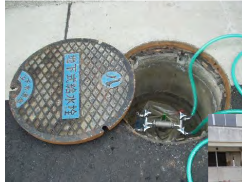
地下式給水栓
